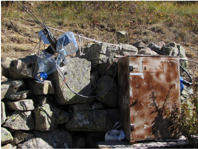
Vue générale de l'installation moteurs et boitier
