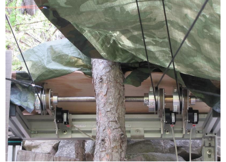
3 moteurs Robofocus pour gestion des câbles Sud
